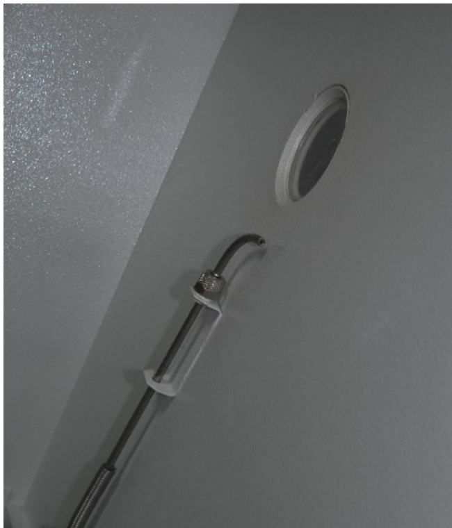
Нерабочее положение трубки подачи аргона
